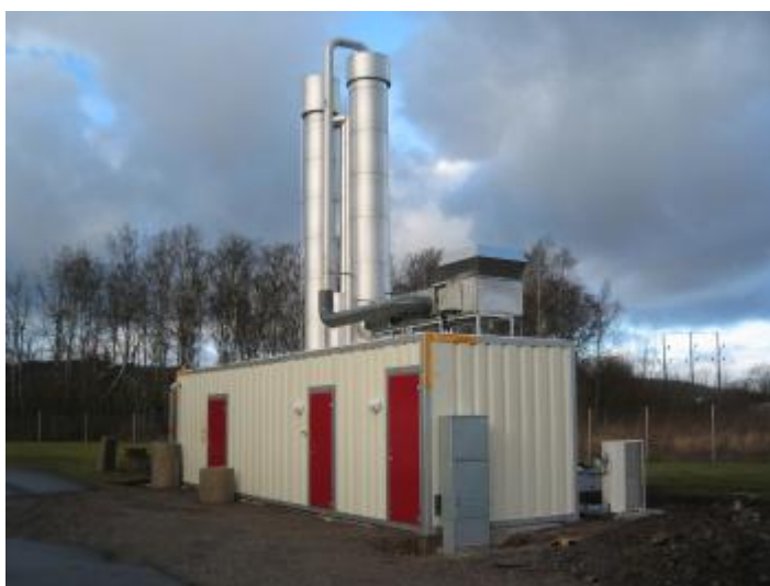
Uppgraderingsanläggning med absorptionstorn och stripperkolonn
