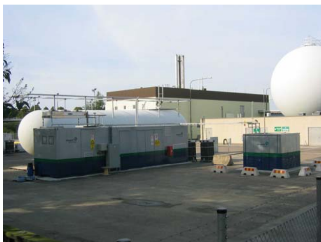
Elektrolysören och vätgaslagret som är placerade inom ett inhägnat industriområde ca 200 m från tankningsanläggningen
