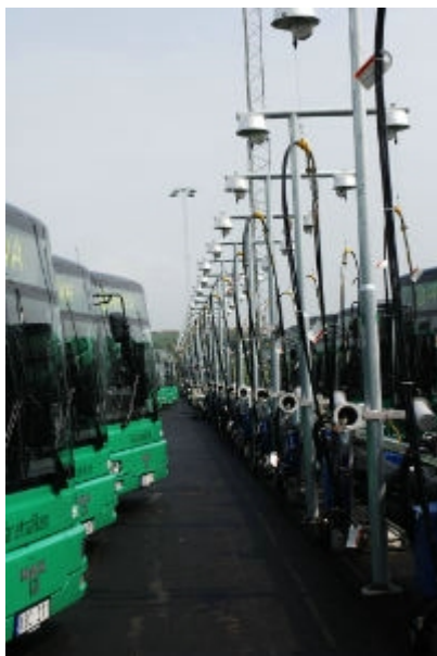
Tankningsramp för långsamtankning vid Busspunkten i Helsingborg
