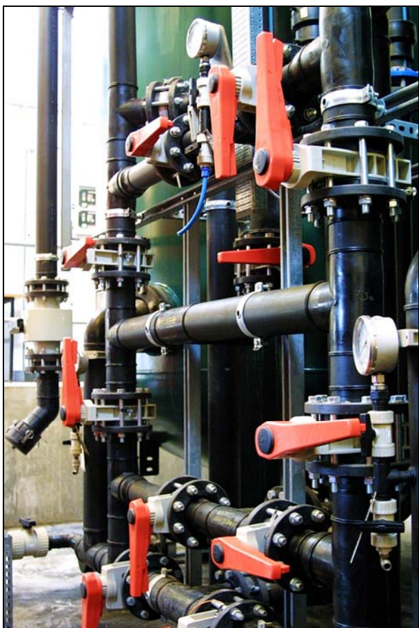
Ventiler på afværganlægget i Allerød
