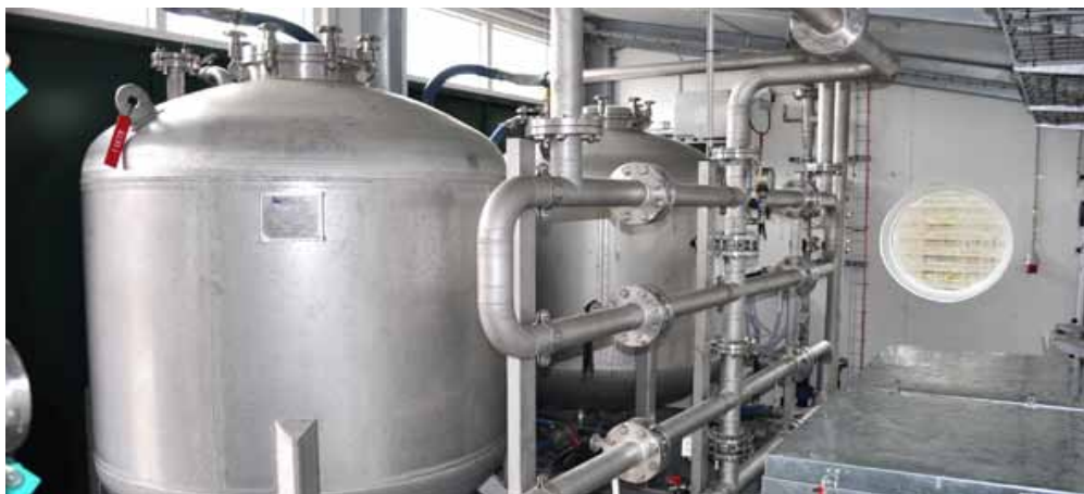
Teknisk oprensningsanlæg der renser forurenede grundvand
